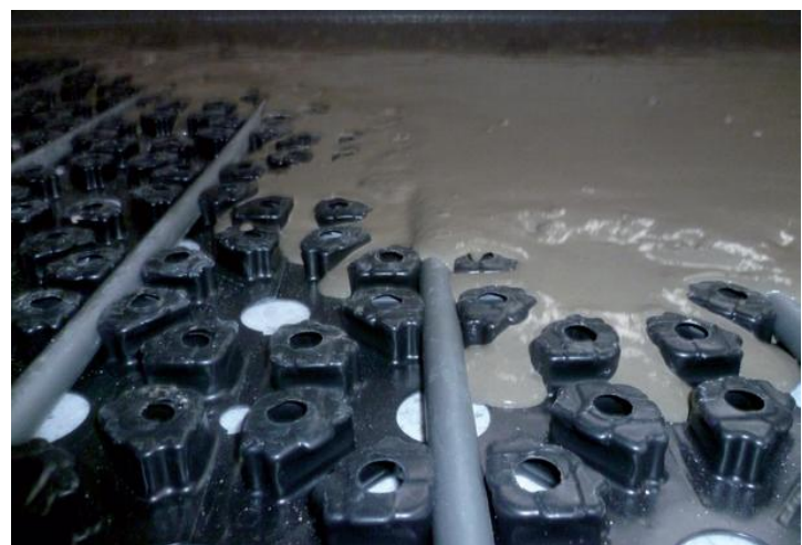
De SoproVezel Nivelleer FAS 551 vloeit in het verwarmingssysteem.
